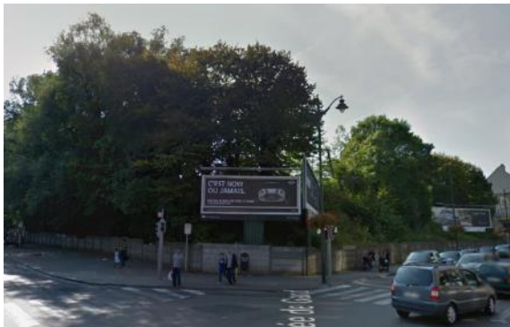
Photo 46 : Mur de soutènement situé au nord-est du site, à l'angle de la chaussée de Gand et de la rue Vandenpeereboom (Source : Google maps)
