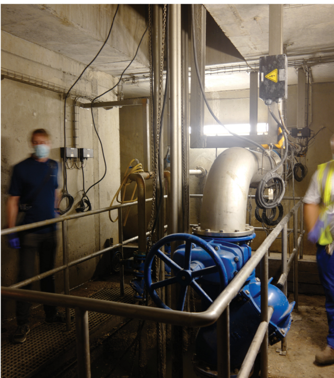
le station de pompage souterraine
