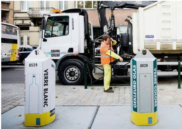
Figuur 25 : Ondergrondse glascontainers van Net Brussel (bron: dhnet.be)
