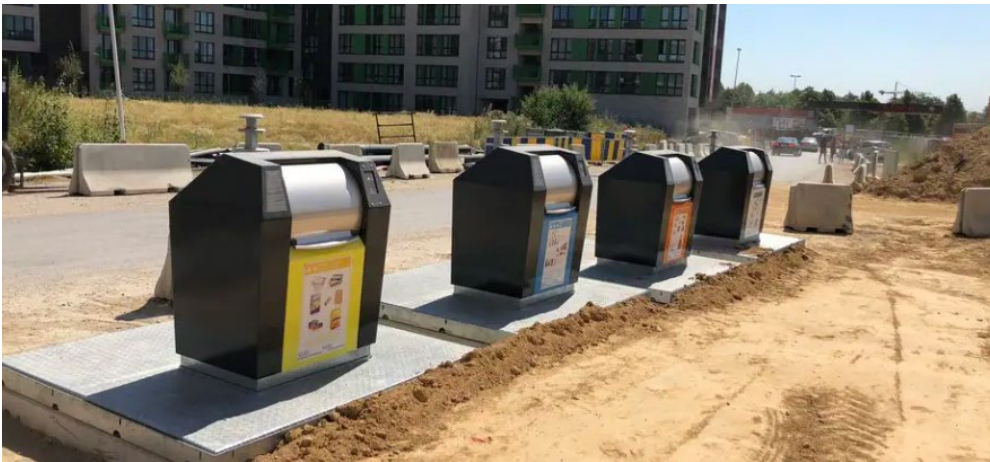
Figuur 27 : Slimme ondergrondse containers, project Erasmus Gardens in Anderlecht (bron: dhnet.be)
