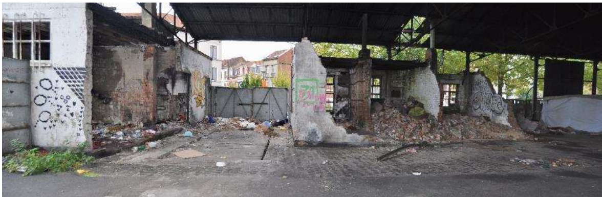
Foto 27: Bouwvallige structuren in de steenkoolhal (Foto : ABO)
