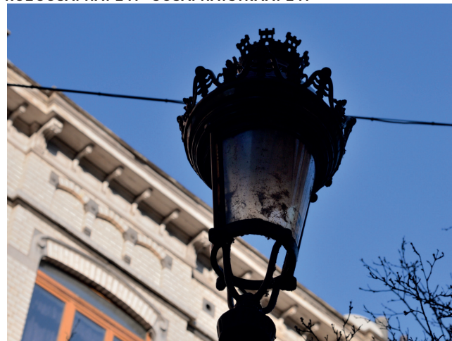
RUE JOSAPHAT QUATRE VÉTUSTES MARQUENT L'ENTRÉE DE L'ÉCOLE 1 - VIER VEROUDERDE AAN DE INGANG
