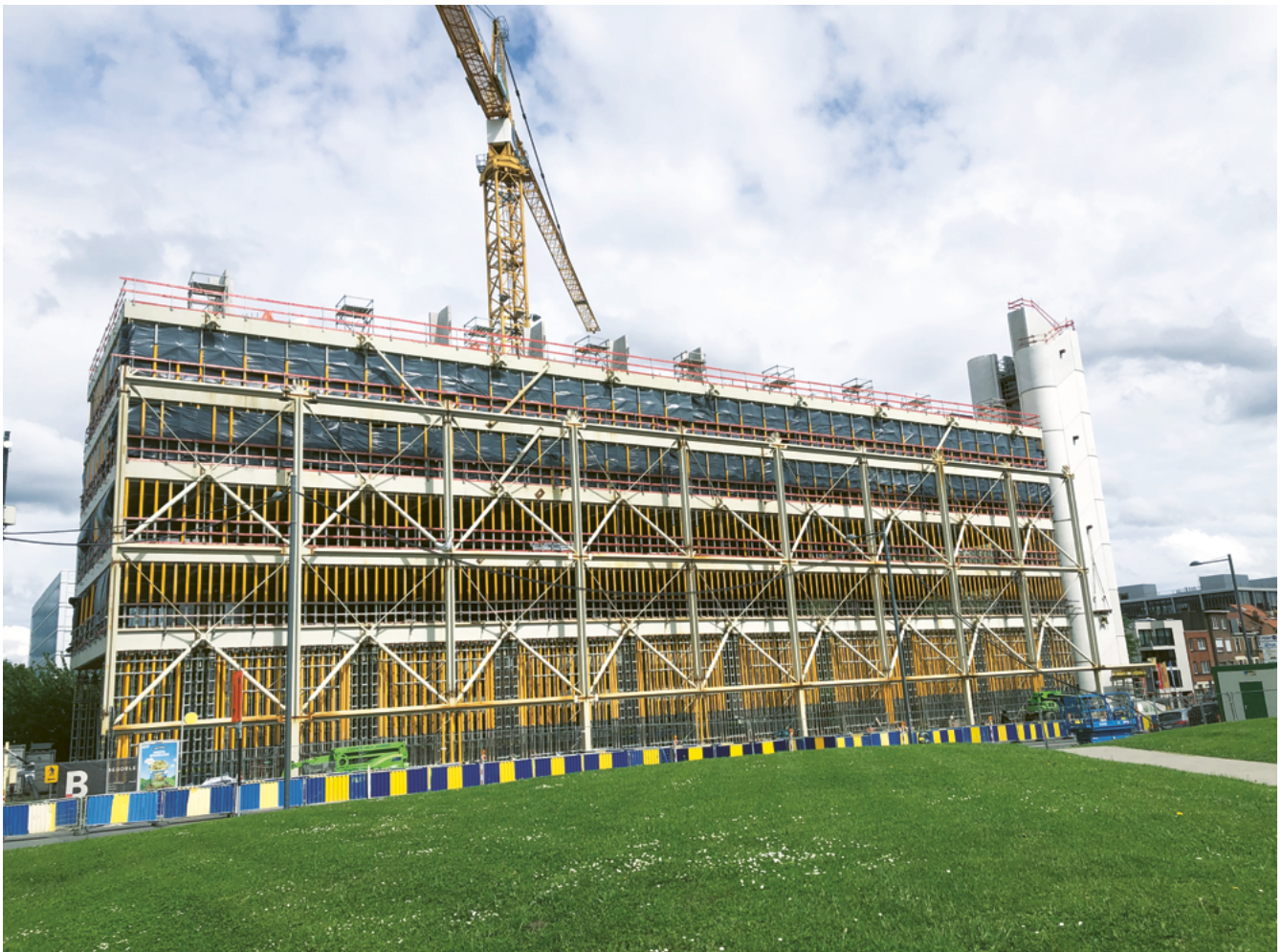
↑ Photo 3 Construction du Frame de Mediapark.brussels, boulevard Auguste Reyers, Schaerbeek (mai 2024) Foto 3 Bouw van het mediacentrum Frame van Mediapark.brussels, Auguste Reyerslaan, Schaerbeek (mei 2024)
