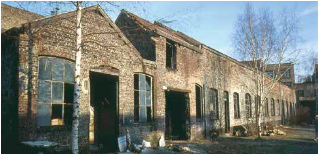
▲ De fabriekshal van de voormalige bronsmaatschappij in Molenbeek in 1998 voor de transformatie in een museum.
